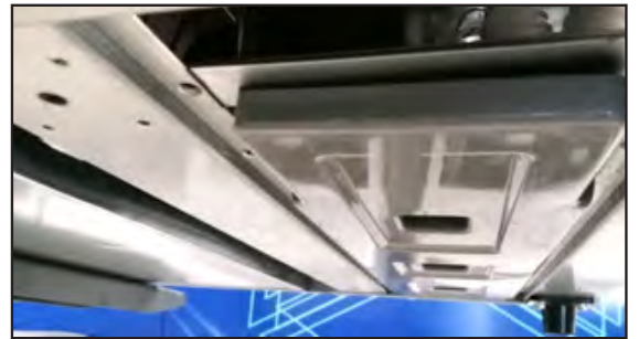
Charola de condensado instalada
