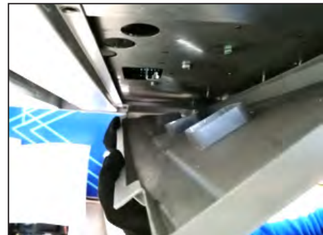
Charola de condensado retirada
