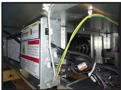
Boîte électrique de contrôleur
