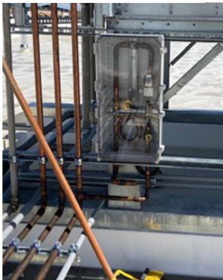
Exemple d'installation par un tiers
