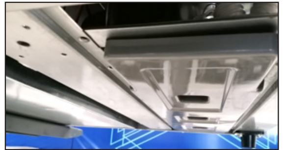
Charola de condensado instalada
