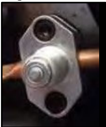
Válvula de toma de la línea de refrigeración
